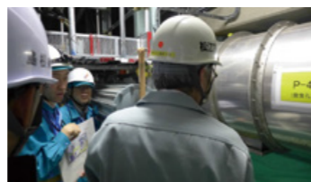
ダクトの腐食状況を確認する県と市の職員(第2回立入調査)
