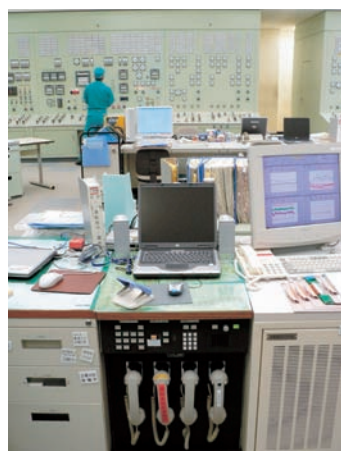
松江市消防本部への専用直通回線 （島根原子力発電所中央制御室）
