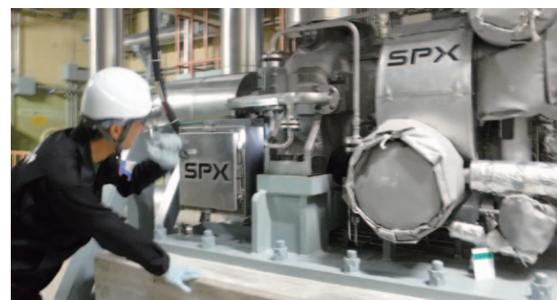
高圧原子炉代替注水ポンプの検査 (中国電力(株)の行った使用前事業者検査が適切に実施されていることを国が確認)
