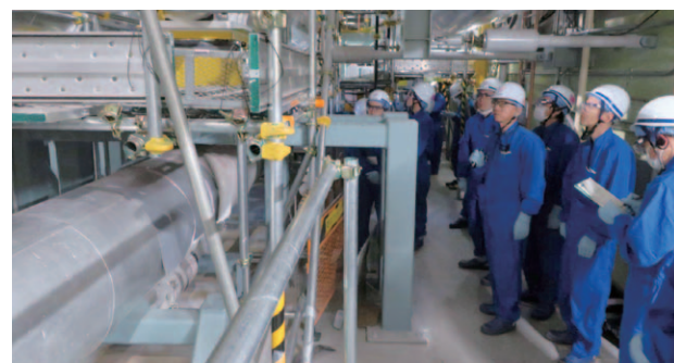
竜巻飛来物から建屋の外気取入口を守る設備(上) 主蒸気管の耐震補強工事の現場(下)
